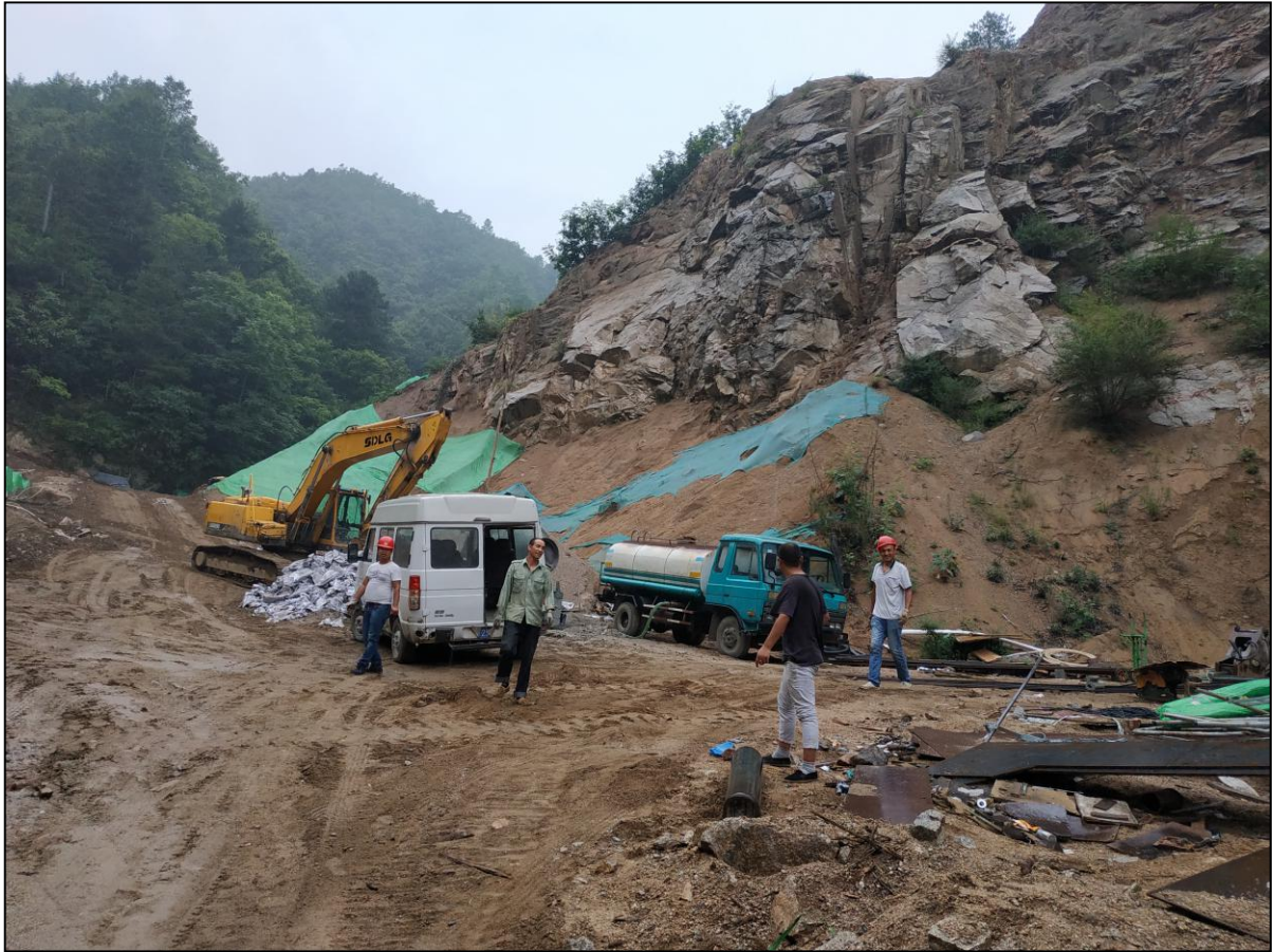
照片 3-2 矿区地形地貌破坏现状
