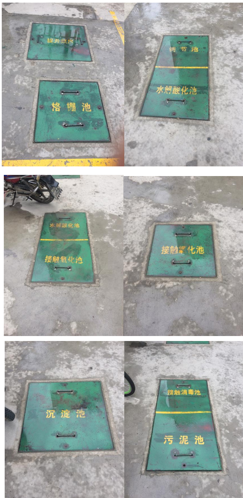
医院现有污水处理站工艺照片
